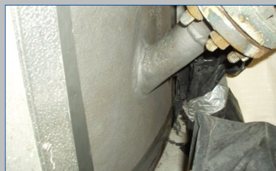
受腐蚀的管嘴
