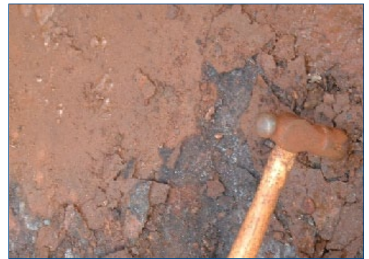
近视图：腐蚀的平台甲板
