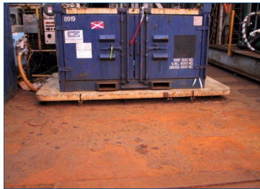
腐蚀的平台甲板
