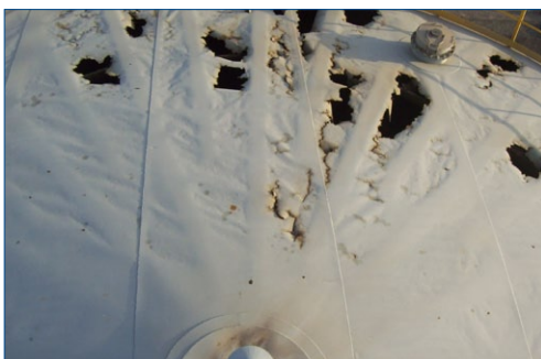
储罐顶部穿孔
