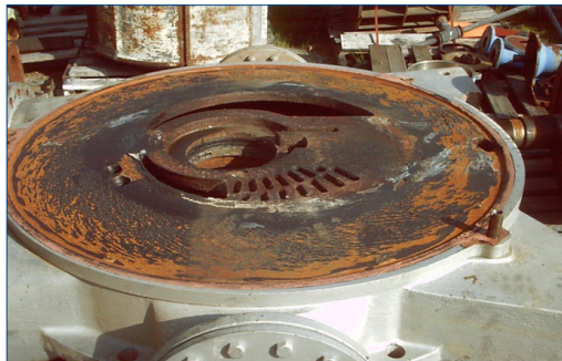
配流盘受到侵蚀-腐蚀损害
