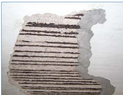
Abplatzen von Beton durch korrodierte Armierung
