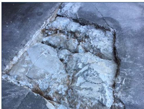
Betonschäden durch starken Verkehr
