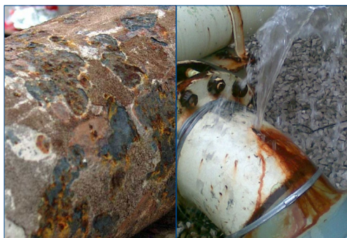
Abb. 1: Erosion, Korrosion und Lochfraß: Wanddurchbrüche führen zu Undichtigkeiten
