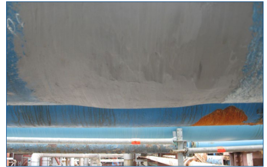
Temporäre Laminierung auf durchlöcherter Fläche
