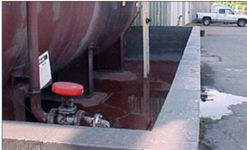
Dommages du béton dû à l'échec du système
