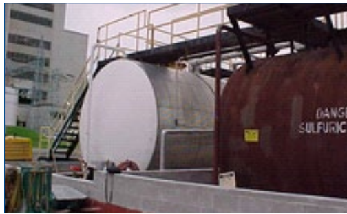
Zone de confinement d'acide sulfurique (droite) et caustique (gauche)
