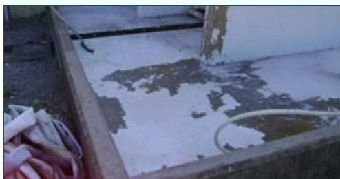
Bac de 98% d'acide sulfurique nécessitant une réparation
