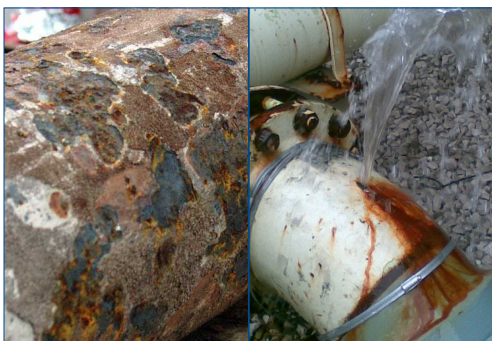
Fig 1 : Érosion, corrosion et dommages par piqures.
