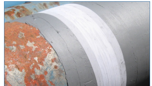
Belzona 1831 (Super UW-Metal) Remplissage final et enveloppe
