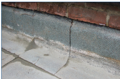
Fuite de joints
