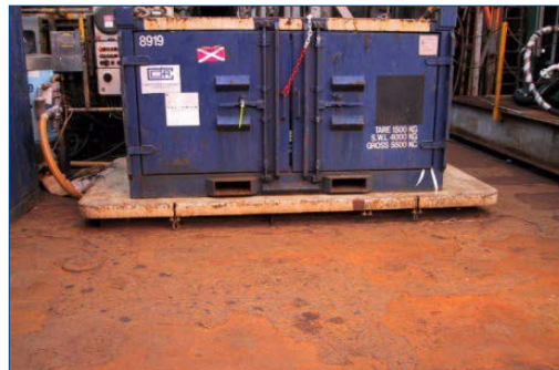
Deck oxidado de plataforma
