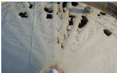
Tampa furada de reservatório
