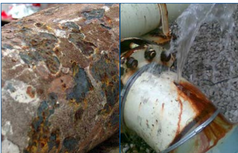
Fig. 1: Danos por erosão, corrosão e corrosão puntiforme Danos através das paredes resultando em vazamentos
