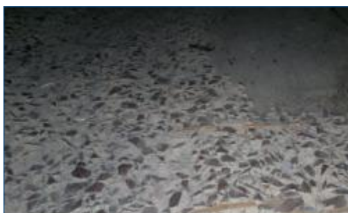
Изношенный железобетонный канал
