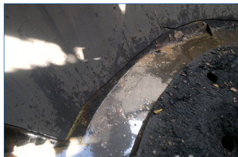
Поврежденная эрозией-коррозией флотационная камера
