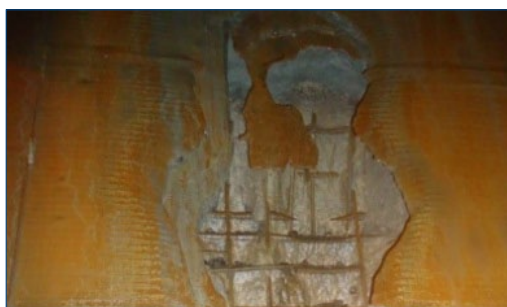
Поврежденные области бетонного поглощающего колодца
