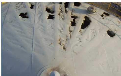
Дырявая крыша резервуара
