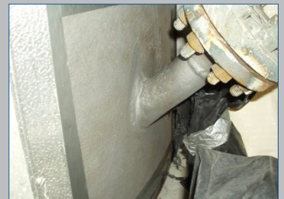
Патрубок, пораженный коррозией
