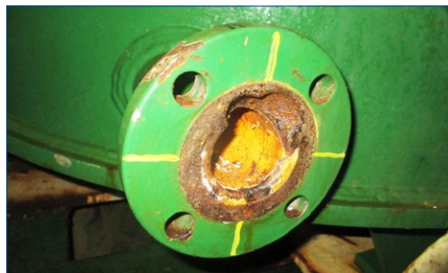
Поверхность фланца сильно корродирована
