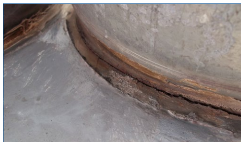
Разрушенный стык в системе ОВК
