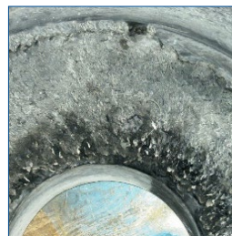
Поврежденное резиновое покрытие корпуса насоса
