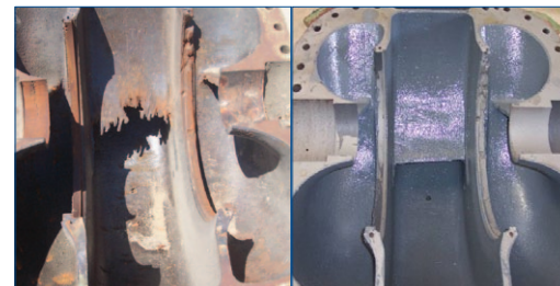
Эрозия-коррозия водореза центробежного насоса
