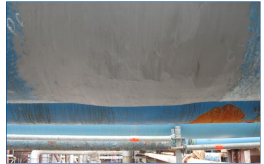
Temporäre Laminierung auf durchlöcherter Fläche
