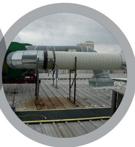
Conduits de climatisation
