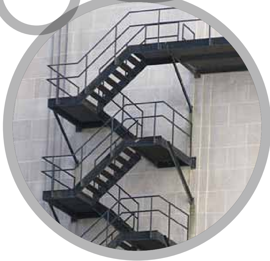
Escaleras de incendios
